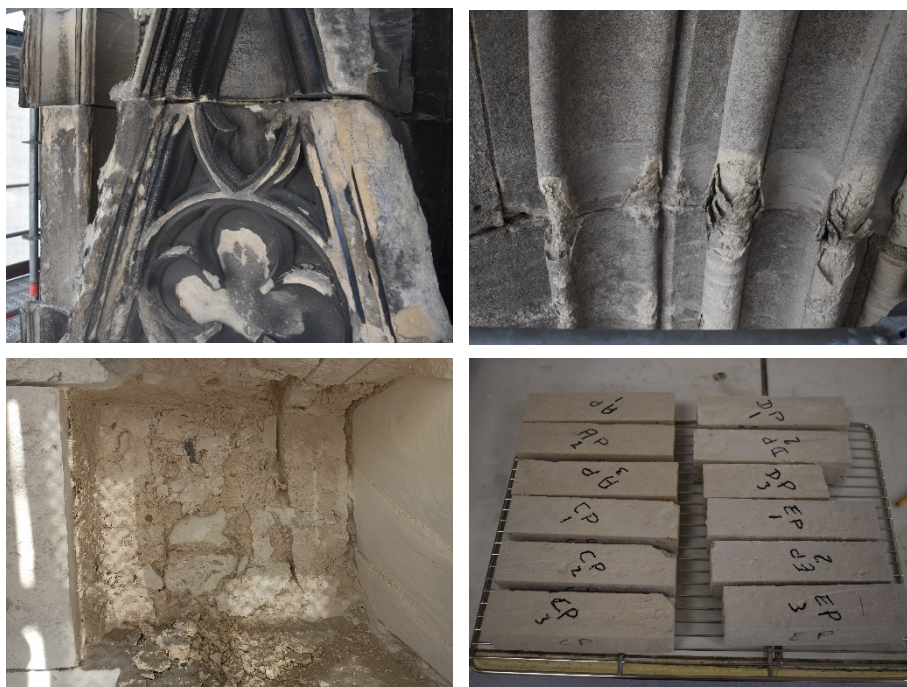
Vues de dégradations des assises de pierre et étude des mortiers compatibles pour les remplacements de pierre (photos ECMH)
