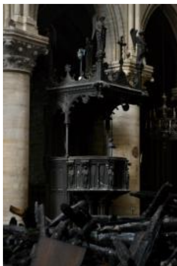
Chaire à prêcher de la nef après l'incendie
