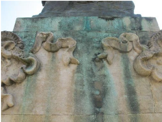
Monument Joseph Roumanille à Saint-Rémy-de-Provence ; taches d'oxydes de cuivre prononcées sur une pierre calcaire poreuse. (photo C Botbol)
