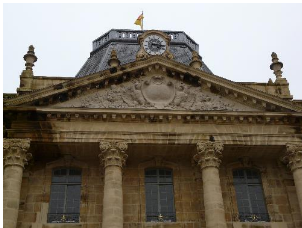
Château de Lunéville ; apparition de patines manganésifères sur les grès à la suite de l'incendie. (photo J.-D. Mertz, LRMH)
