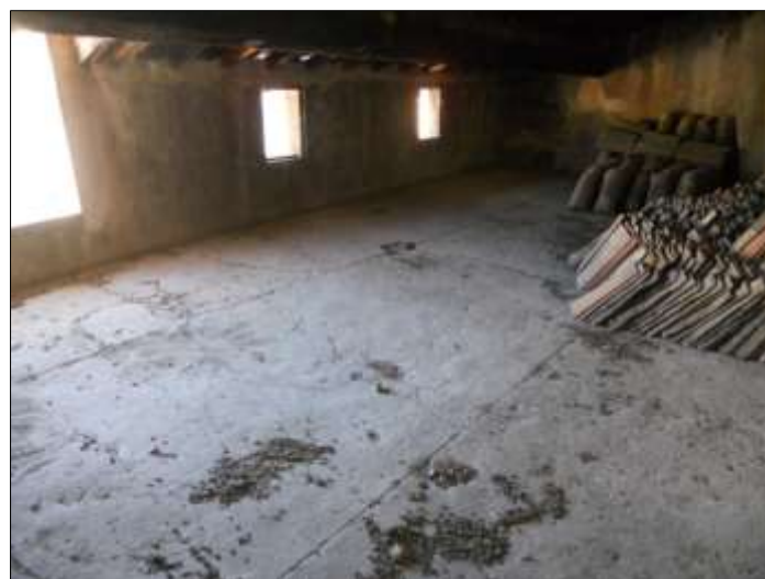
Fig. 8 : Hôtel Ferrier, Riez (Alpes-de-Haute-Provence). Au dernier étage se trouve une dalle de plâtre gris-rosé à nue. La dalle est coulée et coffrée sur place, directement sur les solives du plafond. Les fissurations linéaires dessinent des « rectangles » qui représentent les aires de coulée. Dans les étages inférieurs, les dalles de plâtre sont toutes recouvertes d'une chape plâtrée dans laquelle sont scellés les carreaux de terre cuite. Photo Julien Salette.
